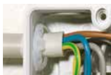
Dragavlastning med en avlastningsring för kablar
