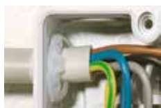
Dragavlastning med en avlastningsring för kablar
