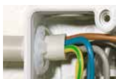
Dragavlastning med en avlastningsring för kablar
