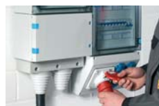
Kopplingsdosa för kontaktanordningar, tryckknappar och strömställare under tillbehör
